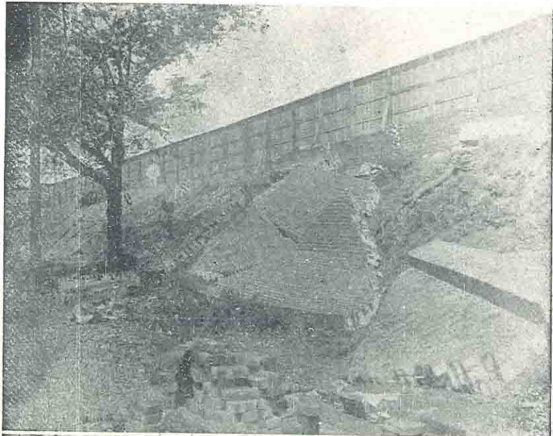
外圍煉瓦塀倒壊の一部
