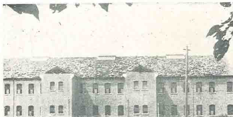
第二雜居監の屋根剥落
